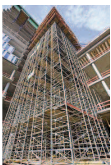
Staxo 100-Rahmen sorgen am Bauteil B für eine schnelle und sichere Unterstellung der weit auskragenden Flachdecken im Rucksackbereich.
