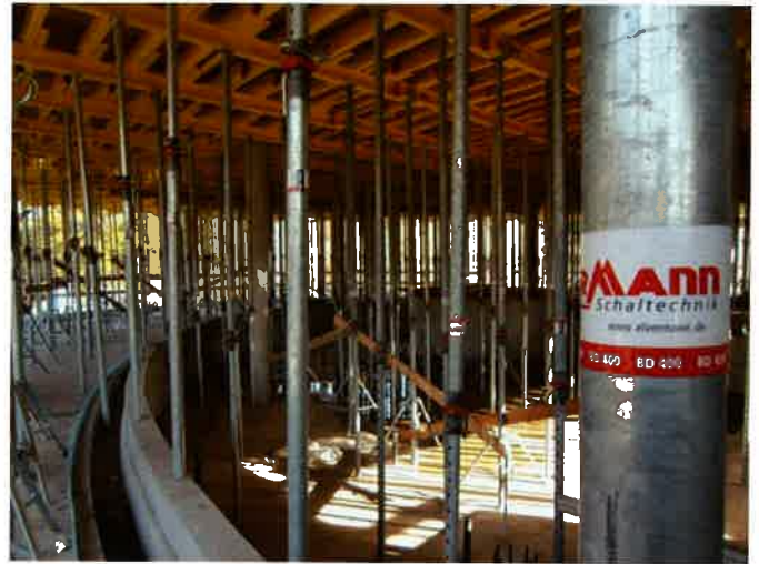
Bild 2. Rund 6.600 m Holzträger und 2.600 Stahlrohrstützen EL-Props in unterschiedlichen Höhen samt Zubehör lieferte Elvermann mit eigenem Kranwagen-Fuhrpark.
